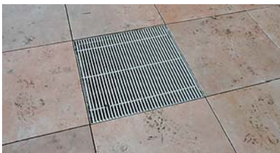
Ryc. 3. Detal podłogi dystansowej tarasu z rewizją instalacyjną Fig. 3. Detail of raised floor of the terrace with an inspection chamber
