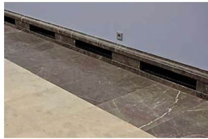
Ryc. 11. Otwory wywiewne nowej instalacji klimatyzacyjnej Fig. 11. Outlets of the new air-conditioning
