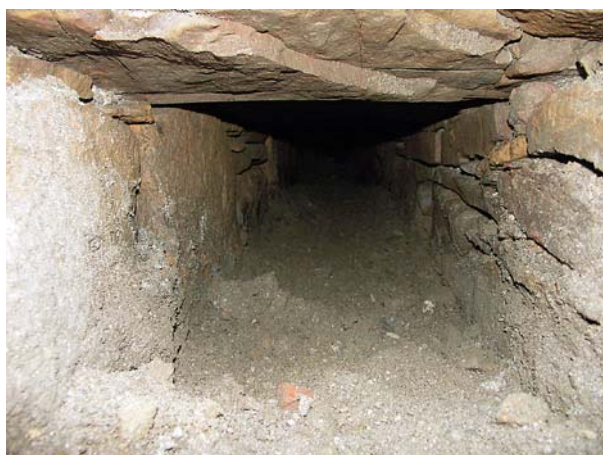
Ryc. 18. Widok wnętrza kanału odwadniającego wzdłuż skrzydła południowego; boczne ściany, dno oraz sklepienie kanału wykonane zostały z płaskich płyt piaskowca. Fot. B. Kwiatkowska-Kopka, 2004 Fig. 18. View of the inside of the drainage canal along the south wing; the sides, bottom and the ceiling of the canal were made from flat sandstone slabs. Photo B. Kwiatkowska-Kopka, 2004
