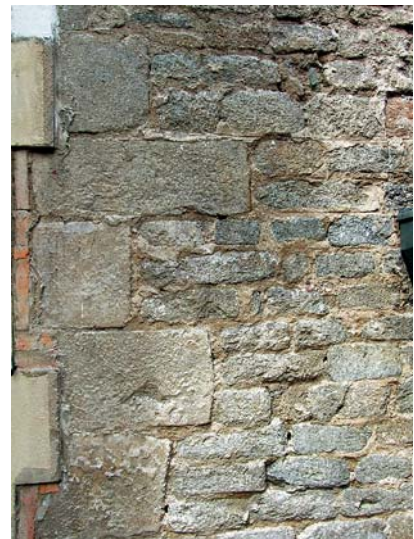
Ryc. 10. Zewnętrzny narożnik południowo-zachodni budowli romańskiej zachowany w południowej elewacji zamku. Fot. K. Stala Fig. 10. External south-west corner of the Romanesque building preserved in the south elevation of the castle. Photo: K. Stala
