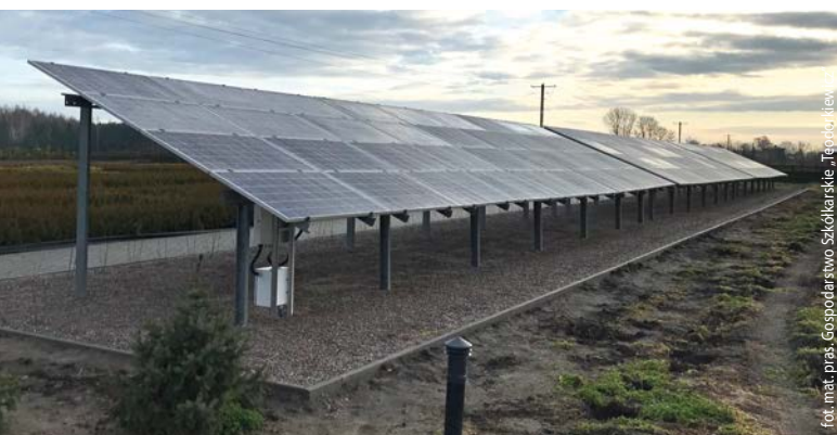
Minifarma paneli słonecznych zabezpiecza zapotrzebowanie energetyczne dla celów produkcyjnych oraz oświetlenie gospodarstwa
