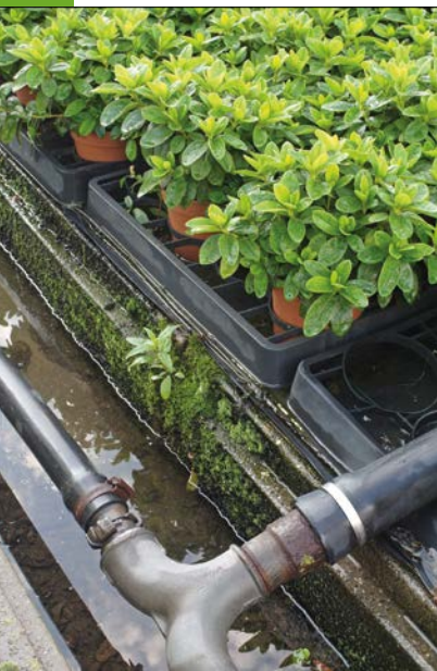
W szkółce z Laarne wprowadzono zamknięty obieg wody fot. I. Sprzączka
