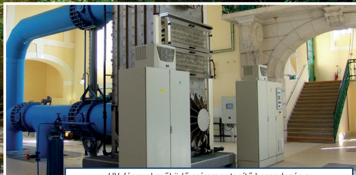
UV-fényvel működő csíramentesítő berendezés a Fővárosi Vízművek Főtelepén
