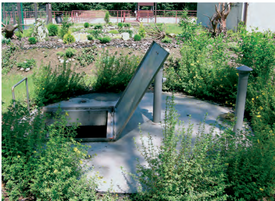
Zestaw hydroforowy zlokalizowany w podziemnej studni (Nadleśnictwo Rudy Raciborskie)
