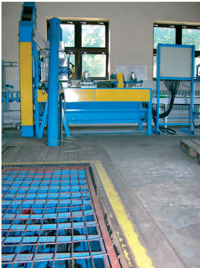
Automatyczna linia napełniania kontenerów – na pierwszym planie zasobnik na substrat umieszczony pod poziomem posadzki, na drugim podajnik ślimakowy (Nadleśnictwo Rudy Raciborskie)
