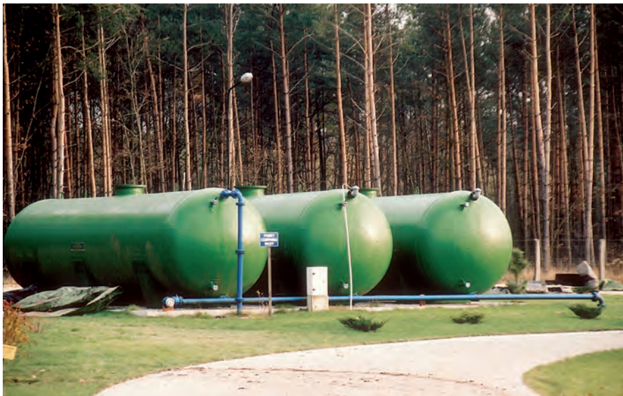
Zamknięte, napowietrzne zbiorniki wodne w szkółce Nadleśnictwa Jabłonna
