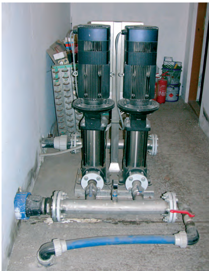
Zestaw pomp hydroforowych tłoczących wodę do instalacji nawadniającej – na pierwszym planie widoczne „awaryjne” zasilanie w wodę wodociągową (Nadleśnictwo Gidle)
