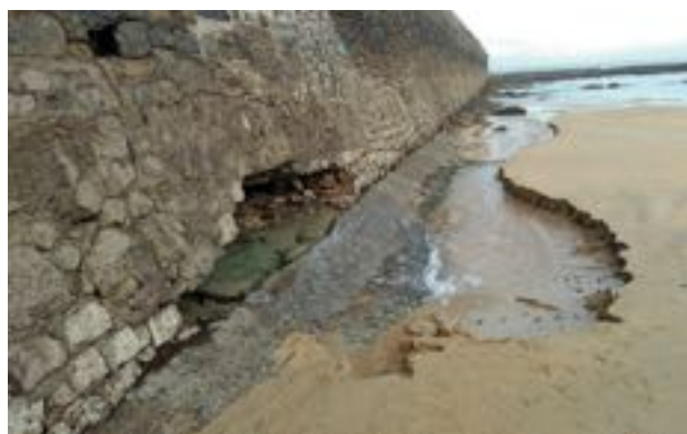
Figura 15. El agua escapa de la cavidad del colector en las bajamares (30-01-2018).
