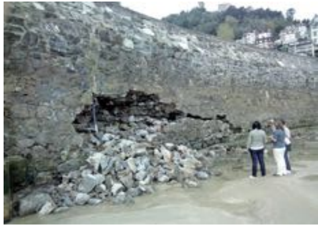
Figura 12. Técnicos municipales inspeccionando los destrozos del muro del Tenis (24-10-2013).
