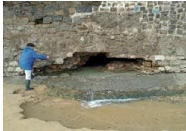
Figura 14. Apertura en el muro de costa afectando a la pared externa del colector (30-01-2018).
