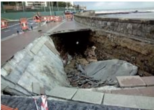
Figura 13. El desperfecto del muro de costa convertido en gran socavón (02-11-2013).
