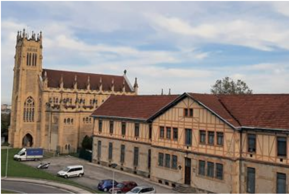
Sede Aranzadi en Zorroaga (Donostia-San Sebastián), el edificio es de 1910 y el tejado necesita de importantes reparaciones.
