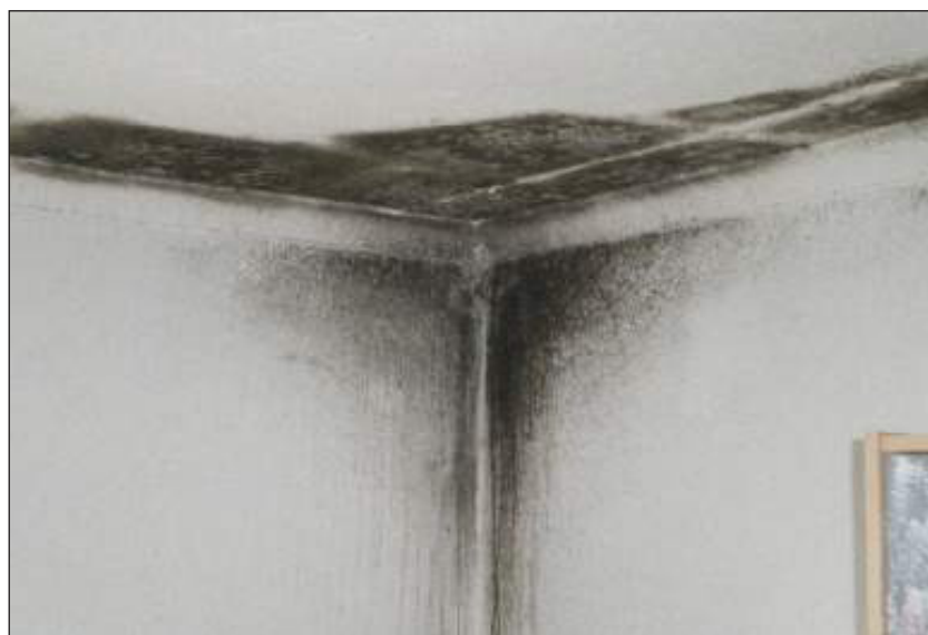
W nieprawidłowo ocieplonej ścianie zbiera się wilgoć i po kilku latach mur stanowi doskonałe podłoże do rozwoju grzybów i pleśni.
