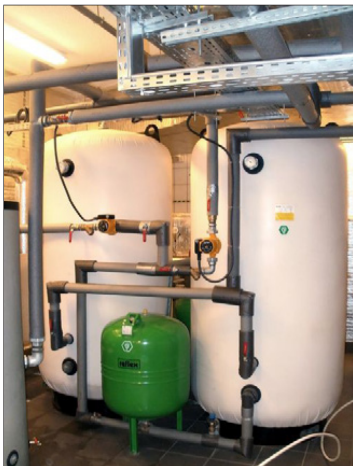
Magazynowanie ciepła w dużej instalacji solarnej odbywa się w zasobnikach wody użytkowej o pojemności dobieranej w zależności od ilości i profilu rozbioru wody.
