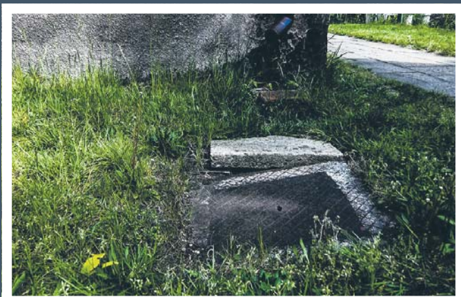
UL. WRZOSOWA 4. Zapadający się kanał
