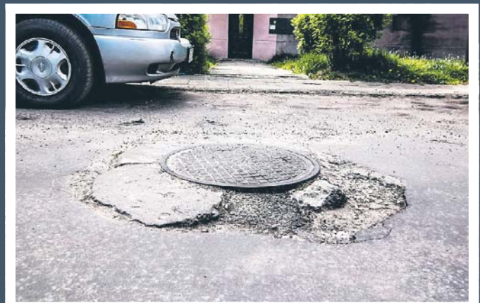
UL. WRZOSOWA 6. Wystający kanał w drodze
