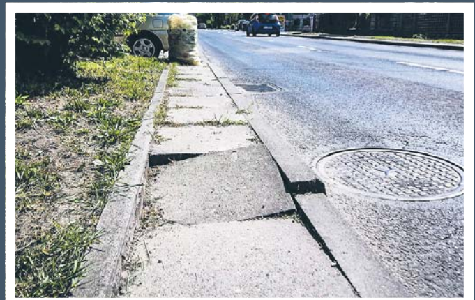
UL. MONIUSZKI 46. Zapadnięty chodnik, jeśli to w ogóle chodnik
