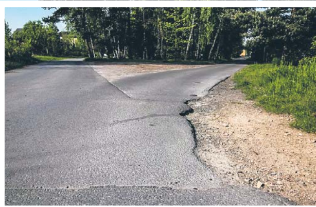
UL. PSZCZELNIK 26. Braki asfaltu
