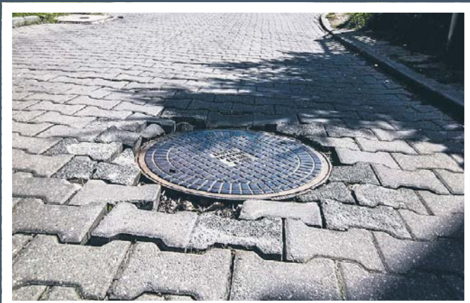
UL. ZEGADŁOWICZA. Uszkodzona kostka przy studziencie
