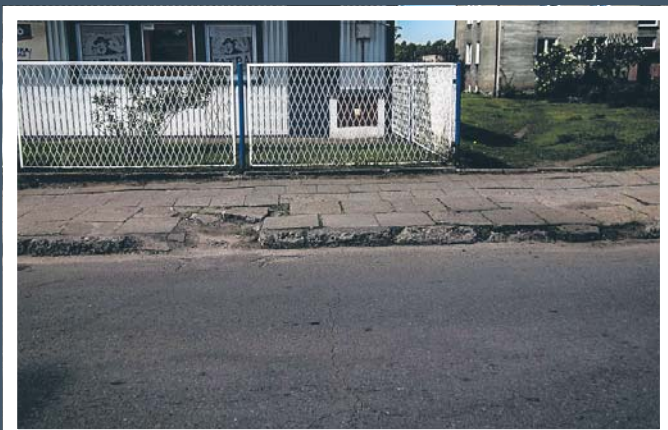
UL. PIASKOWA 56. Brak krawężników
