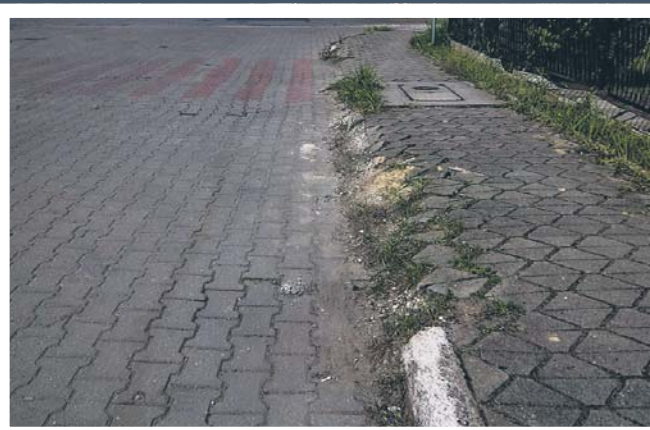
UL. PIASKOWA. Brak krawężników
