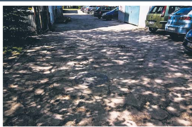
UL. LEŚNA. Uszkodzona nawierzchnia na terenie SP nr 15
