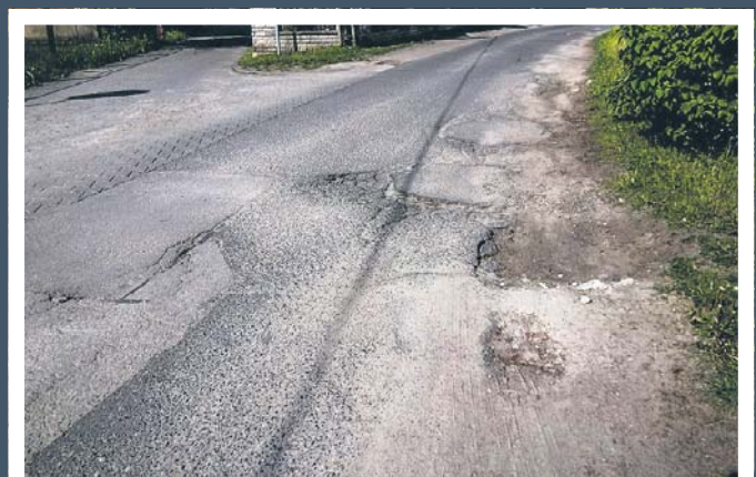
UL. PSZCZELNIK 42. Zdeastrowana droga
