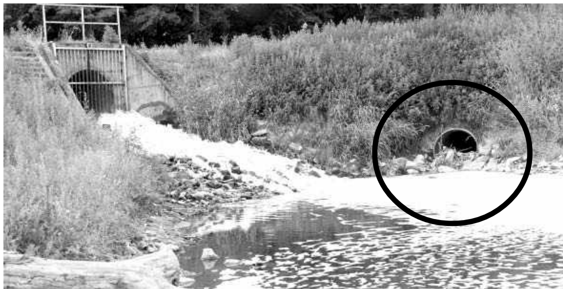
Obok odpływu z oczyszczalni (po lewej) jest wylot miejskiego kanału, którym do rzeki mogą przedostawać się ścieki
