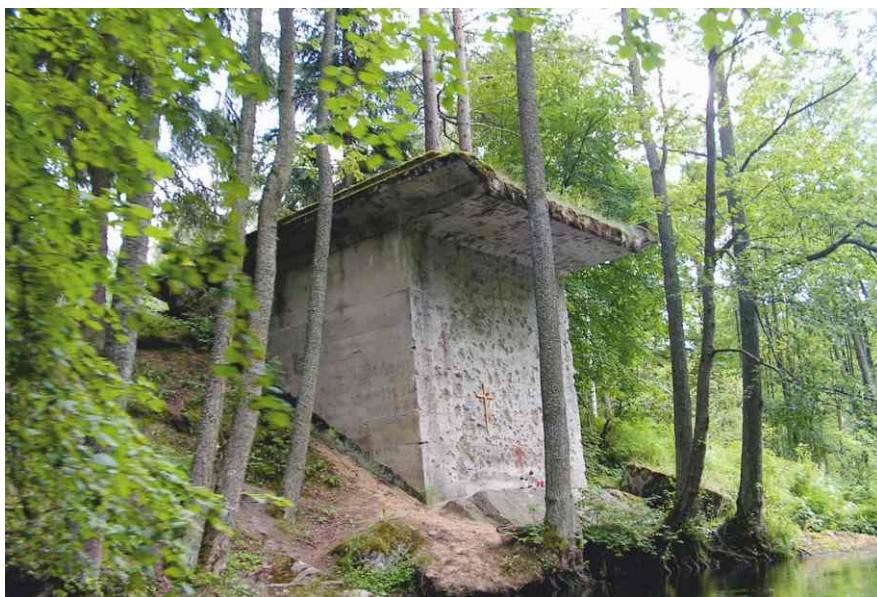
Wysadzony na początku kampanii wrześniowej 1939 most na Wdzie koło Starej Rzeki (fot. Józef Malinowski)
