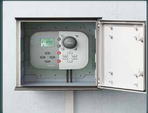
Beregnung: Steuergerät der Serie TEMPUS™ mit WLAN-Modul für Fernsteuerung und Steuerung über das Smartphone.
