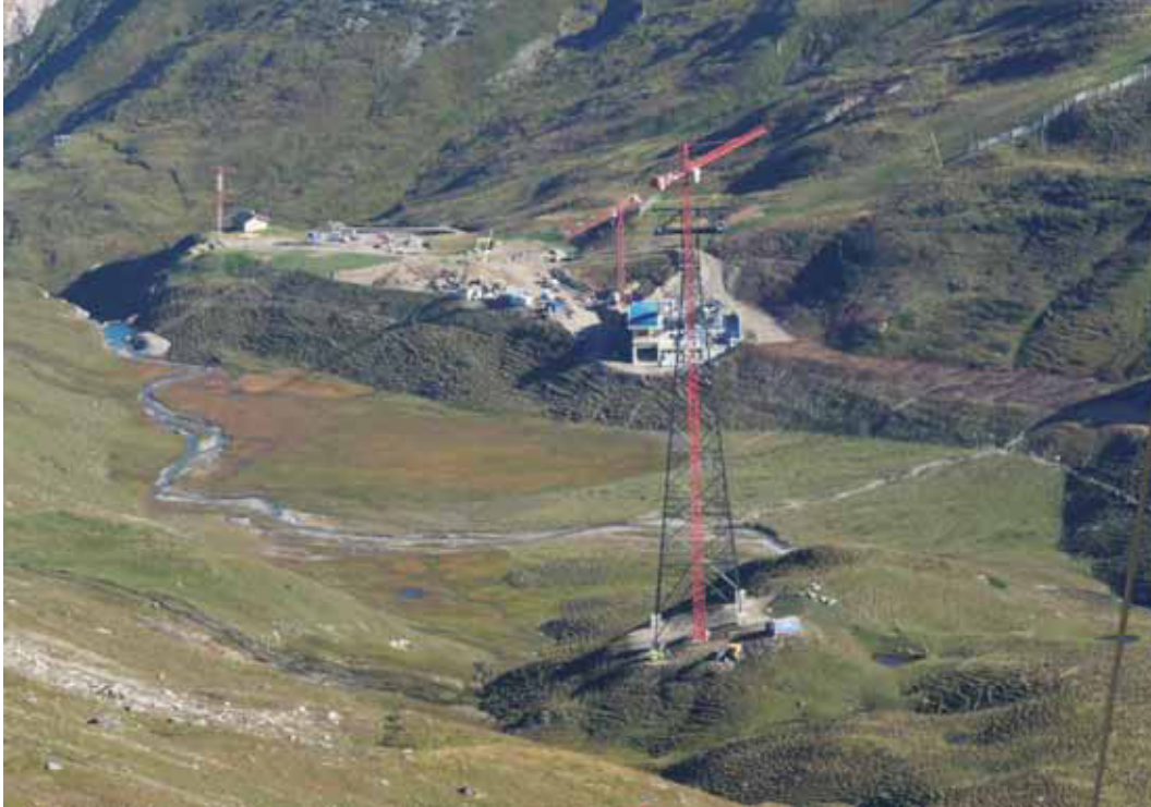
Abb. 3: Schitouristische Bauphase 2013 im Vesital, Talstation der Piz Val Gronda-Seilbahn. Die Dimension der Baumaßnahmen erschließt sich allein schon aus der Höhe von ca. 90 m der Seilbahnstütze im Bereich der Talstation. Foto: © Josef Essl, 7.9.2013.
