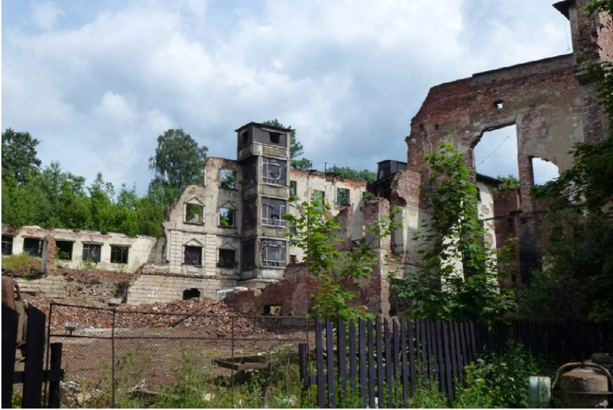
Fot. 59. Ruiny tkalni i przędzalni – obszar między ulicą 3 Maja i ulicą Cmentarną
