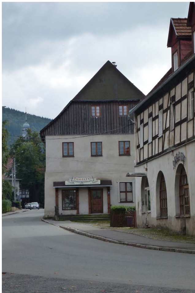
Fot. 10. Dawny magiel wodny, ul. Wyszyńskiego 9. Stan przed remontem, czerwiec 2015. Po prawej stronie zdjęcia fragment elewacji wschodniej historycznego domu handlu płótnem
