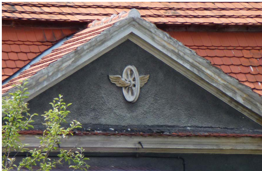
Fot. 85. Uskrzydłone koło w szczycie ryzalitu elewacji wschodniej w budynku dawnego dworca – symbol kolejnictwa
