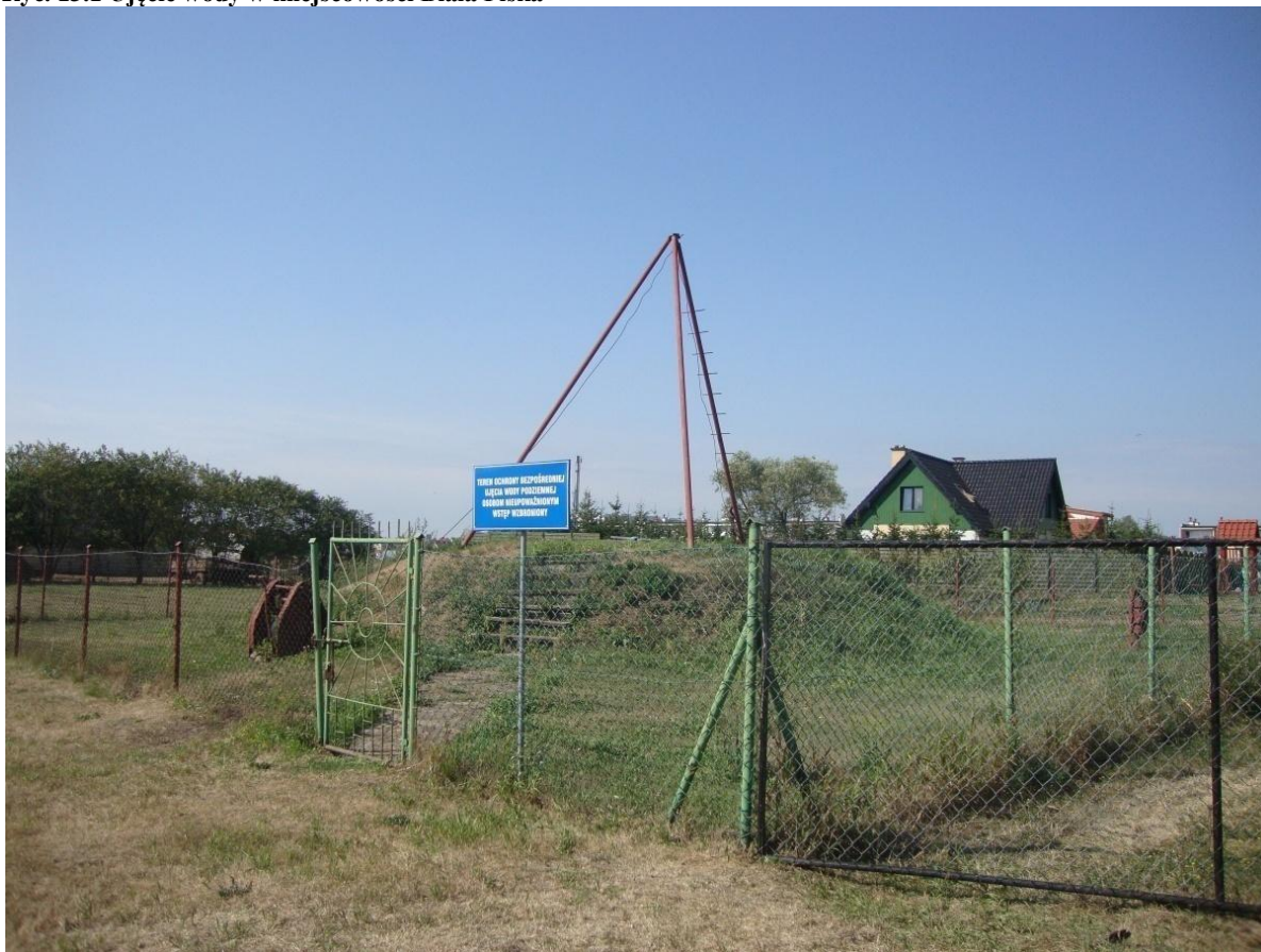
Ryc. 13.1 Ujęcie wody w miejscowości Biała Piska
